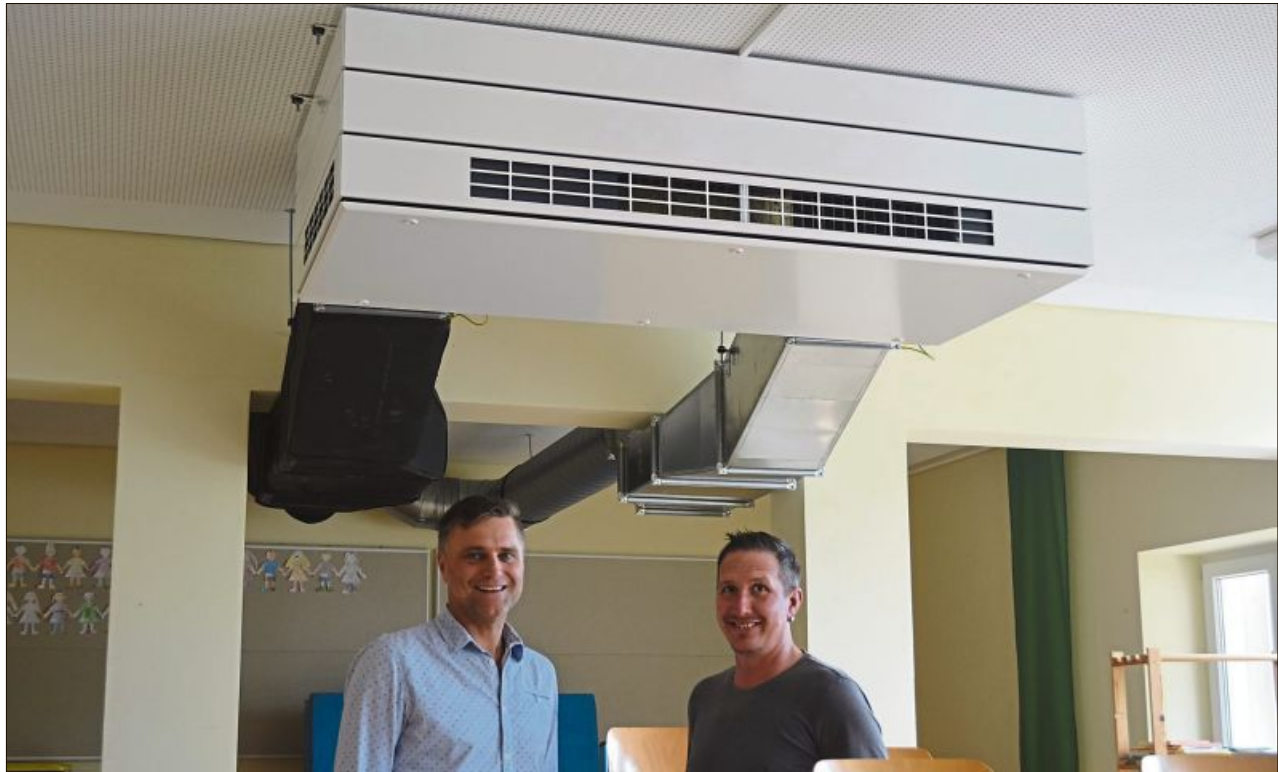
Der Mooser Bürgermeister Alexander Zacher und der Leiter des Technischen Bauamts, Erwin Leher, (v.l.) im Klassenzimmer unter dem neu installierten Lüftungsgerät.
